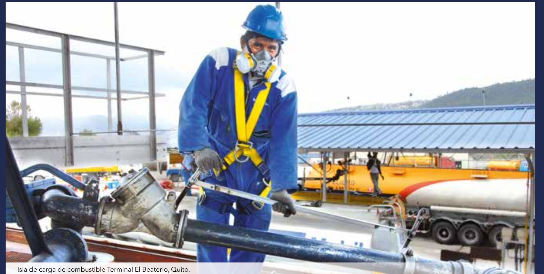
Isla de carga de combustible Terminal El Beaterío, Quito.
