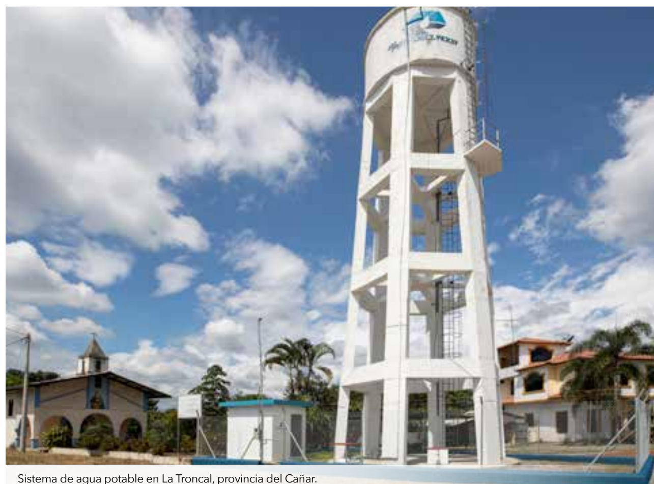
Sistema de agua potable en La Troncal, provincia del Cañar.
