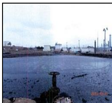
Niveles altos en piscinas
