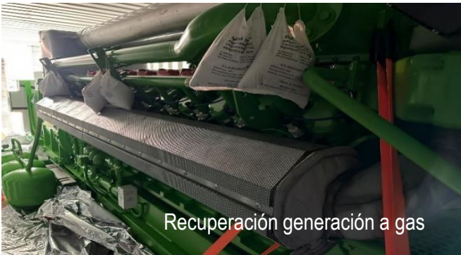
Turbina gas 14 MW TM2500
