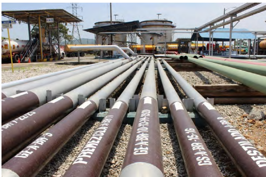
Sistema de poliductos en el Terminal Pascuales, Guayas
