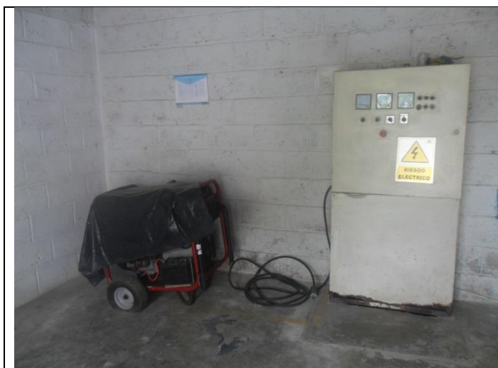
Foto 20. Generador de energía
