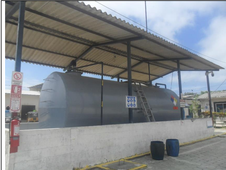
Foto 19. Tanque de almacenamiento de combustible
