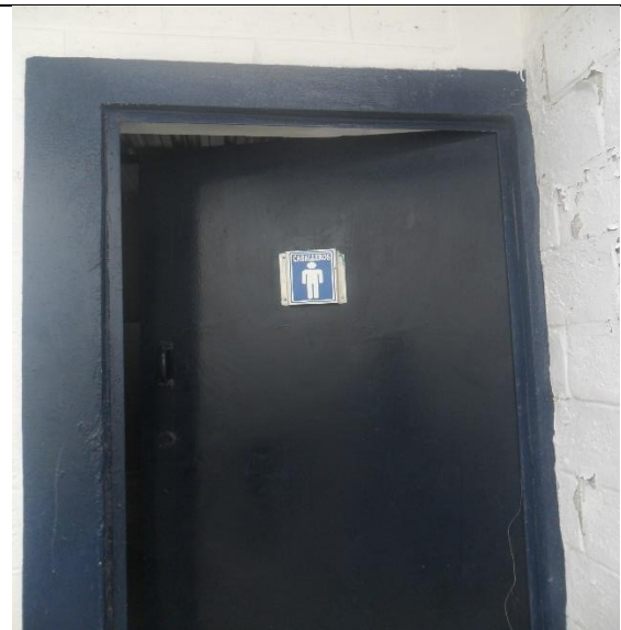
Foto 3. Baterías sanitarias para caballeros.
