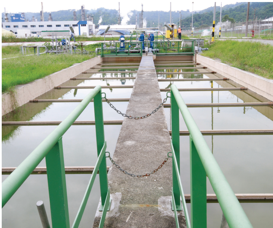
Planta de tratamiento de aguas
